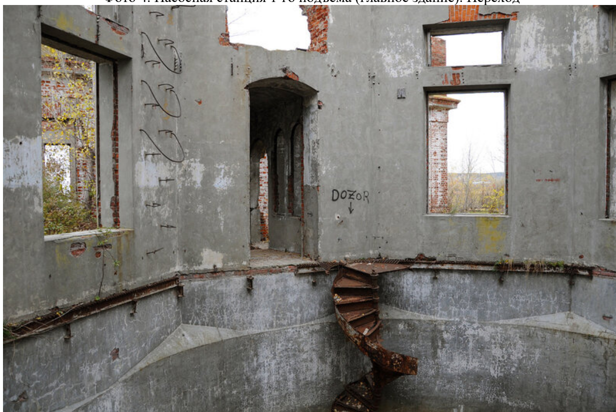
Фото 5. Насосная станция 1-го подъёма (главное здание). Интерьер
