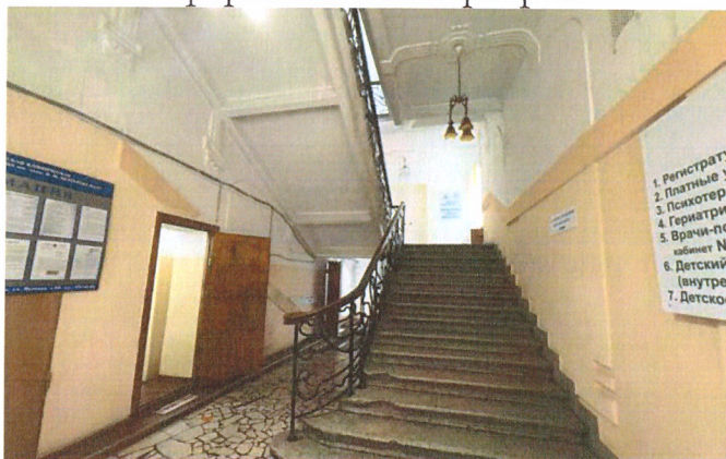
Межэтажная лестница по металлическим косоурам
