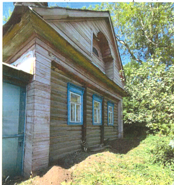
Общий вид северного (главного) фасада (обшивка фронтонов тесом, обшитые тесом, пилястры по углам дома)
