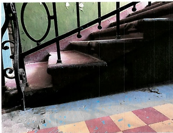
Ступени с валиком лестницы в осях 5-6
