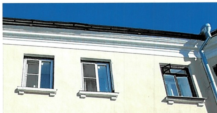
Плоские подоконные полочки под окнами антресольного этажа на прямоугольных кронштейнах и венчающий карниз дворового фасада. Современное фото.
