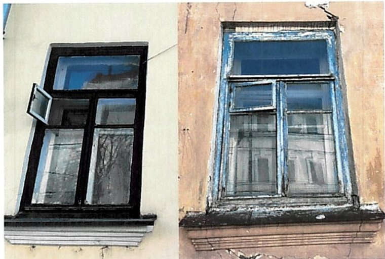
Современное состояние исторических столярных заполнений окон.
