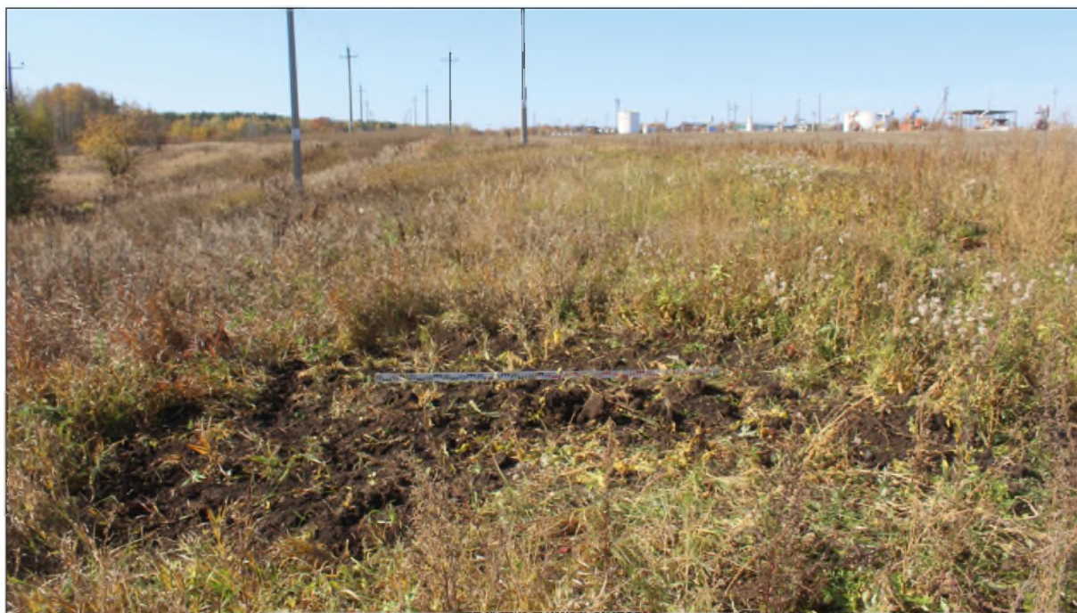
Рис.30. «Строительство высоконапорного водовода от КНС-1 до скв.973». Зюзеевское нефтяное месторождение, Республика Татарстан, Нурлатский муниципальный район. Шурф 2. Рекультивация. Вид с востока.
