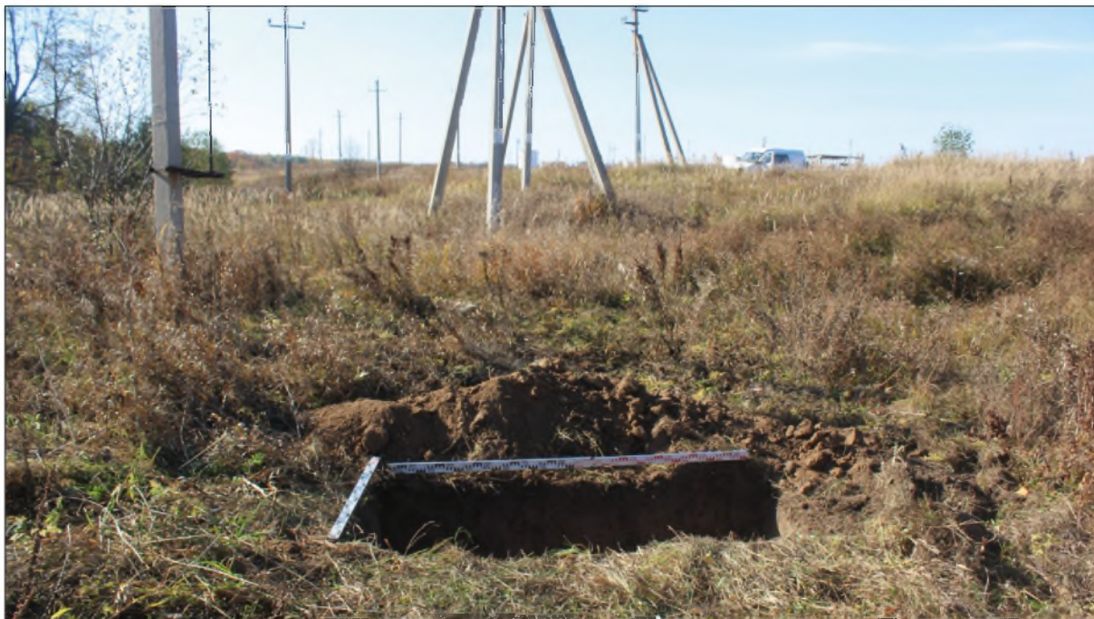
Рис.39. «Строительство высоконапорного водовода от КНС-1 до скв.973». Зюзеевское нефтяное месторождение, Республика Татарстан, Нурлатский муниципальный район. Шурф 4. Вид с востока.
