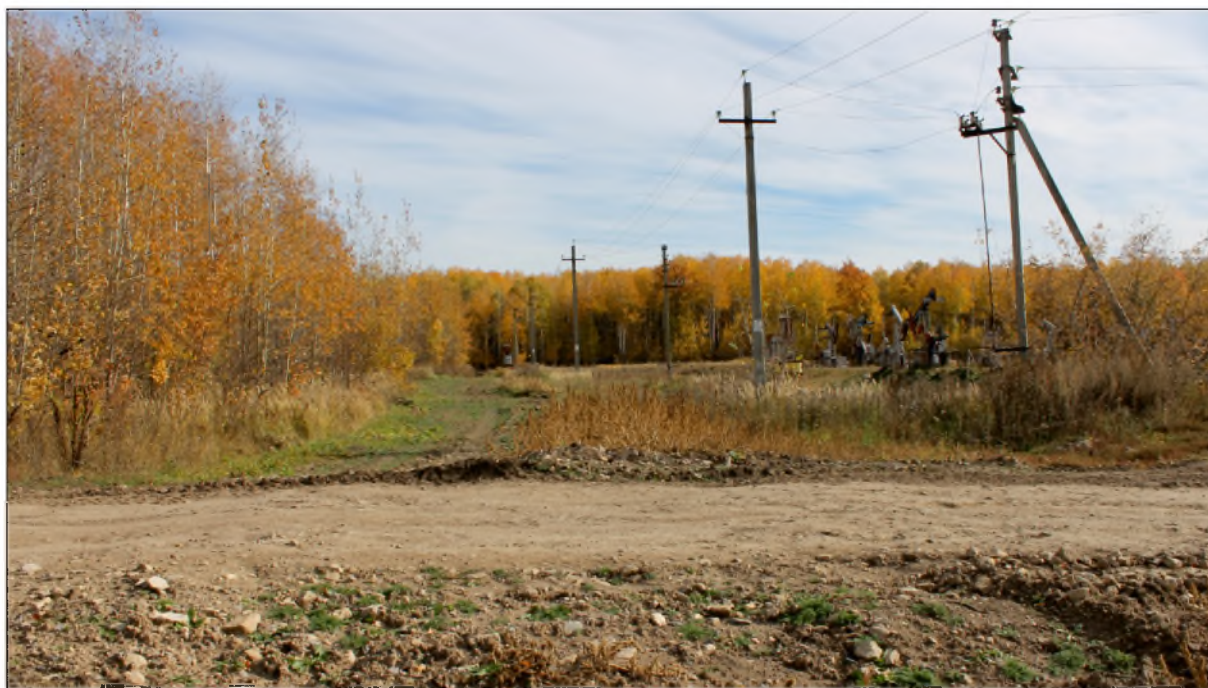
Рис.18. «Строительство высоконапорного водовода от КНС-1 до скв.973». Зюзеевское нефтяное месторождение, Республика Татарстан, Нурлатский муниципальный район. Точка фотофиксации 5. Вид с запада.
