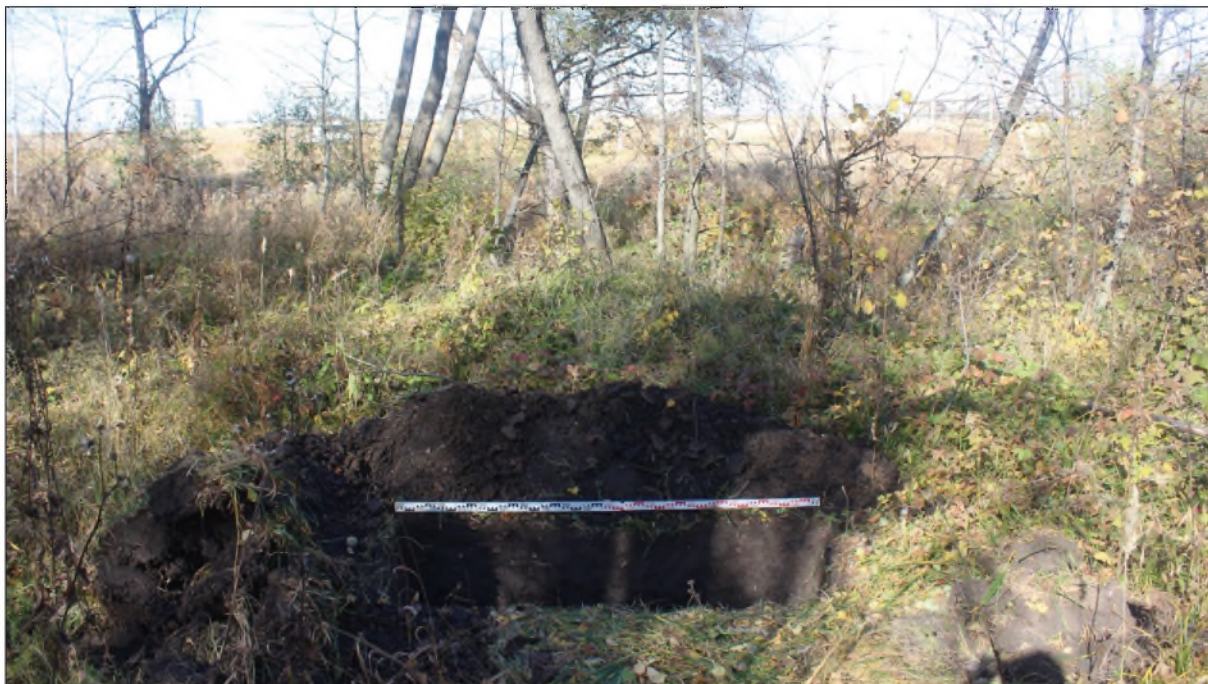
Рис.21. «Строительство высоконапорного водовода от КНС-1 до скв.973». Зюзеевское нефтяное месторождение, Республика Татарстан, Нурлатский муниципальный район. Шурф 1. Вид с юга.
