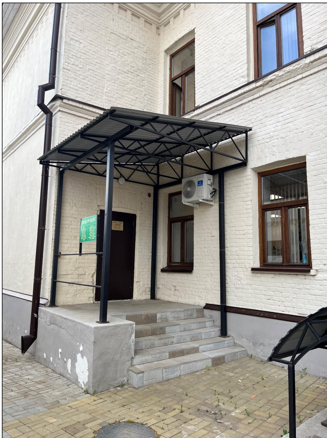
Т.ф. 3. Объект экспертизы. Современная входная группа, внешние блоки кондиционеров, пластиковое заполнение оконных проемов.
