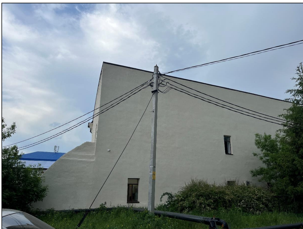
Т.ф. 5. Объект экспертизы. Дворовой фасад. Контрфорс.
