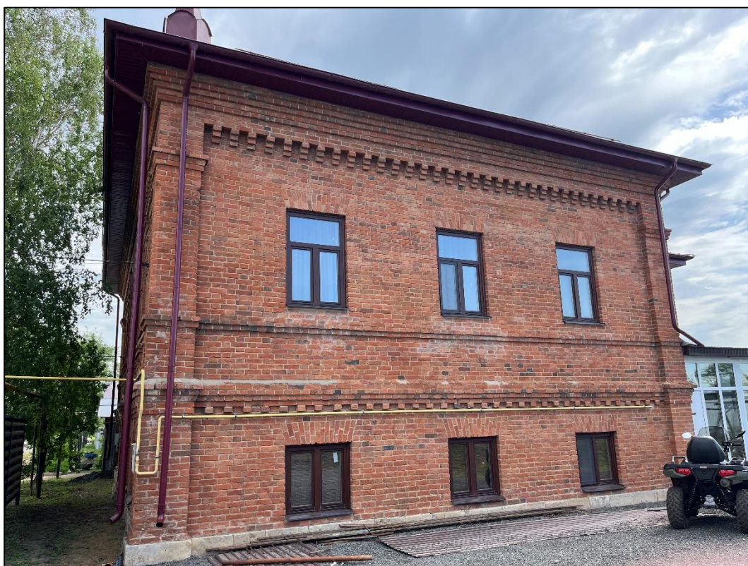
Т.ф. 3. Объект экспертизы. Прясло бокового фасада, обрамленное лопаткам, межэтажный пояс, обрамленный кирпичными обломами с сухариками, венчающий фриз с консолями и раскрепованный карниз. Масштаб окон
