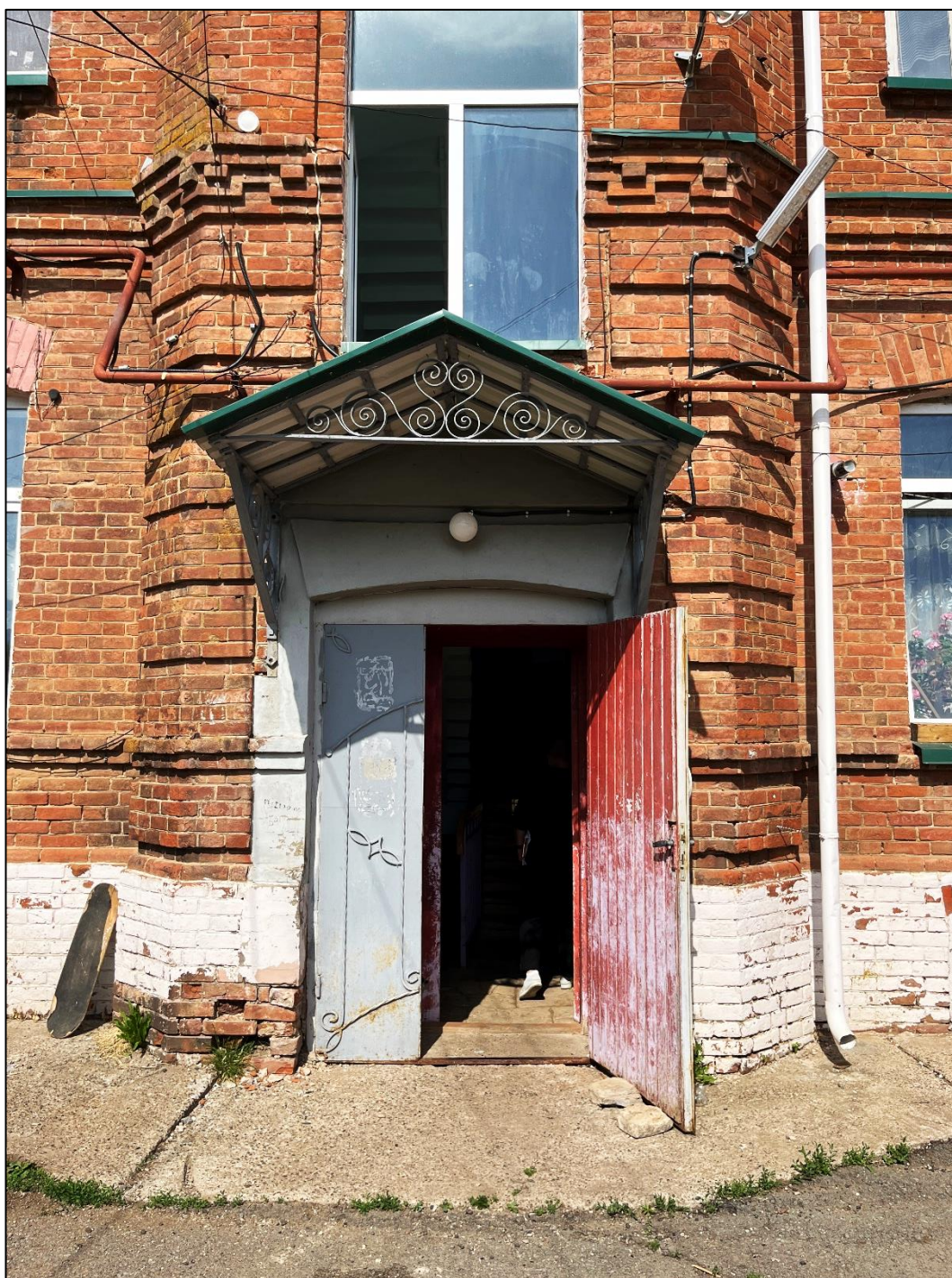
Т.ф. 4. Объект экспертизы. Эркер, входной проем
