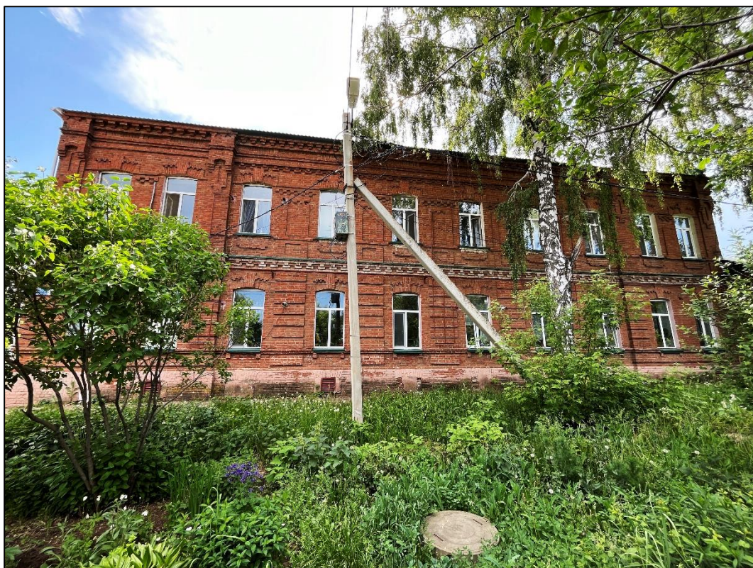
Т.ф. 1. Объект экспертизы (основной объем). Общий вид со стороны улицы Зои Космодемьянской.
