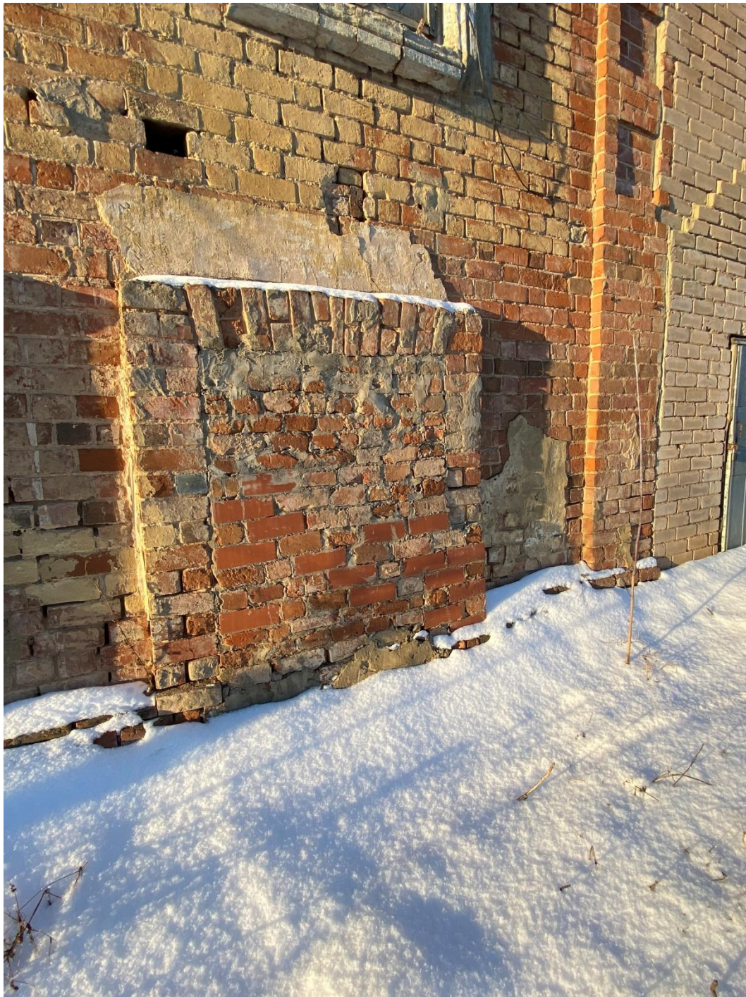
Кадр.№12 Фрагмент торцевого фасада. Заложенный дверной проем Дата съемки: декабрь 2022 г
