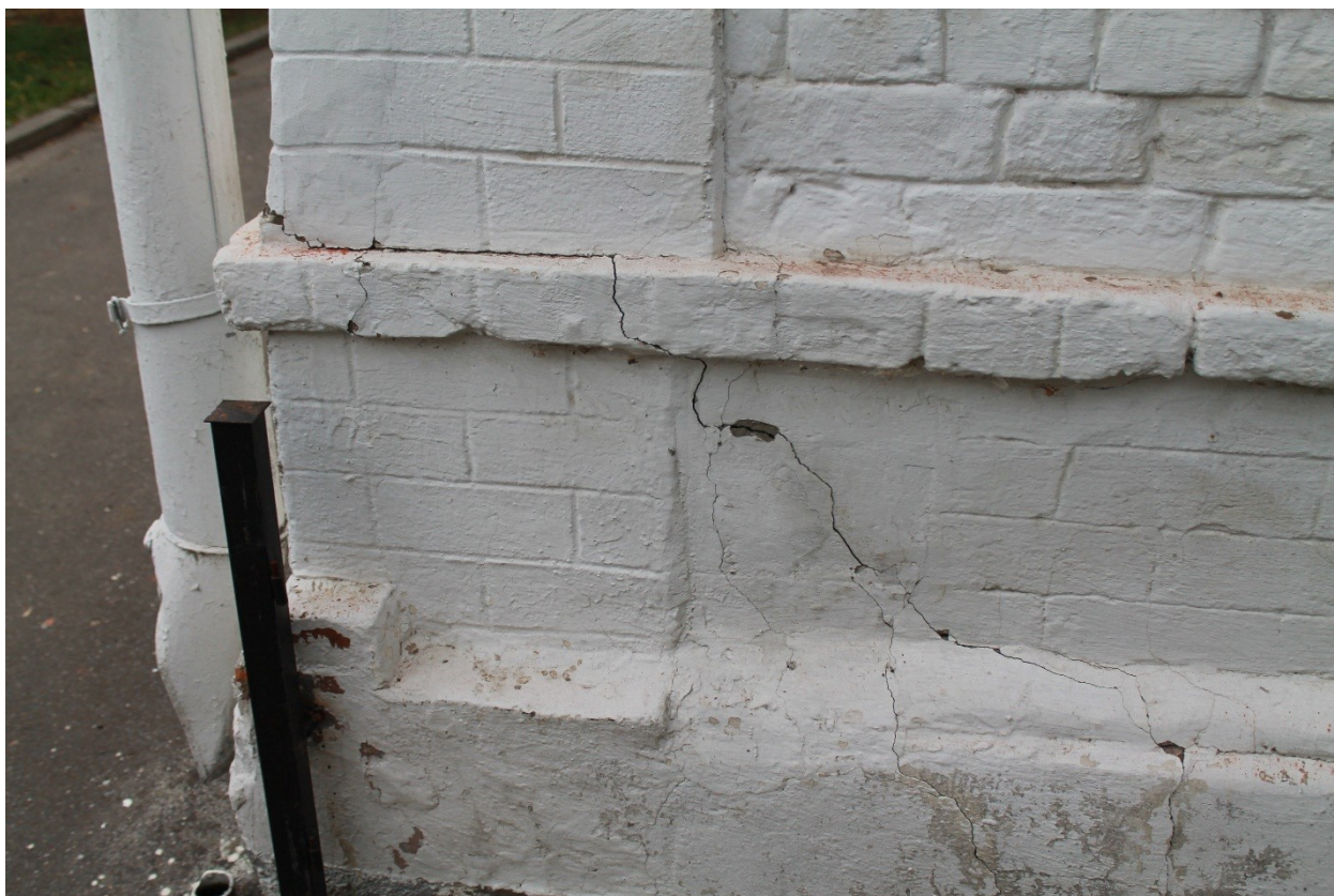
Фото 8. Фрагмент цоколя с трещиной.
