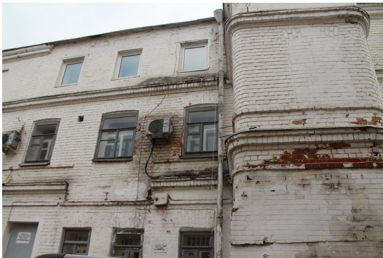
Фото 4. Северо-западный (дворовый) фасад - разрушения.
